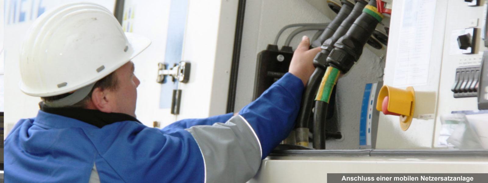
Tanklager Hartmannsdorf, Messwarte
